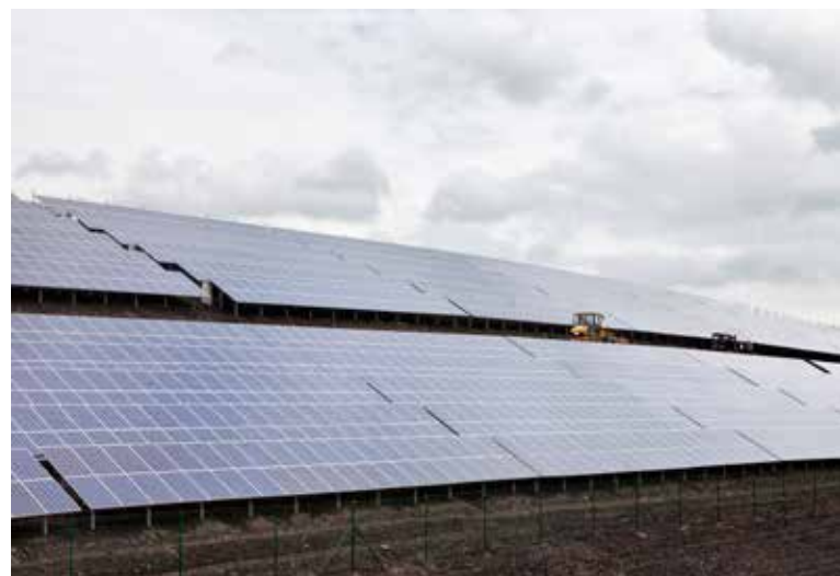
Abbildung 10 Photovoltaik-Freiflächenanlage, © Cindi Jacobs
